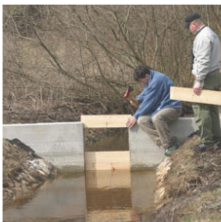
Fot. 3. W ramach programu buduje się zastawki i inne urządzenia hydrotechniczne na rowach melioracyjnych i małych ciekach wodnych w okolicy gniazd (fot. I. Kaługa) Photo 3. Within the program gates and other hydrotechnic devices on drainage ditches and small watercourses are build near the nests
