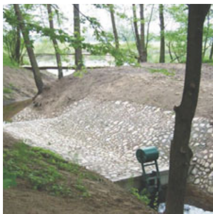
Fot. 3 . Zastawka klapowa jako przykład kolejnego urządzenia hydrotechnicznego.
