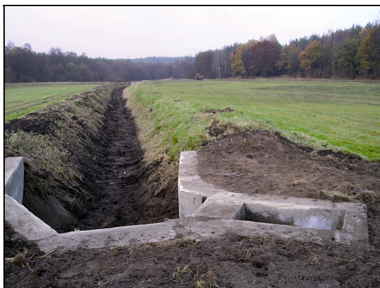
Fot. 5. Kompleks nawodnień w Leśnictwie Laska. Widok jednego z głównych rowów doprowadzających po odmuleniu i renowacji przepustu (fot. Piotr Jankowski)
