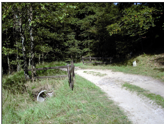
Fot. 3. Dolina rzeki Kulawy. Widok zniszczonego przepustu przed remontem (fot. Wiesława Orzłowska) Photo 3. Valley of Kulawa River. Destroyed culvert before the reconstruction
